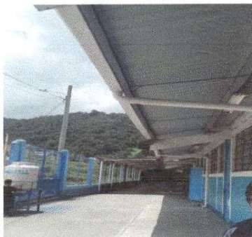
Canales y bajadas de agua
